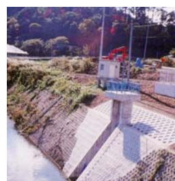
ポンプ場（小坂町）
